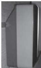
側面から見た隙間の状況
