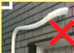
横引き排水管のうねり
